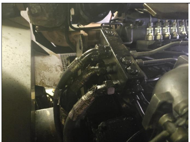
# item 15 – vazamento nas tubulações de alimentação de combustível no motor
