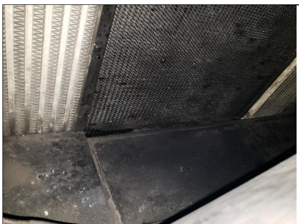
# item 60 – pequeno vazamento no radiador
