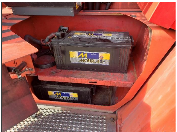
# item 38 – bateria faltando cinta de fixação
