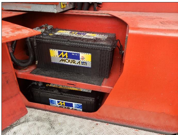
# item 38 – bateria sem cinta de fixação
