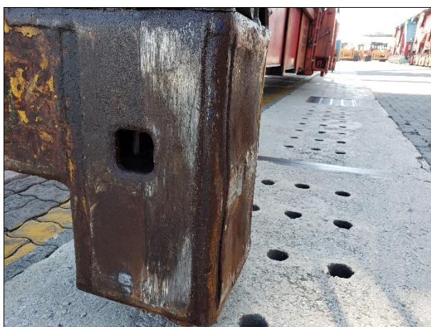
# item 2 – desgaste na chapa do cantop estrutura dos pinos locks
