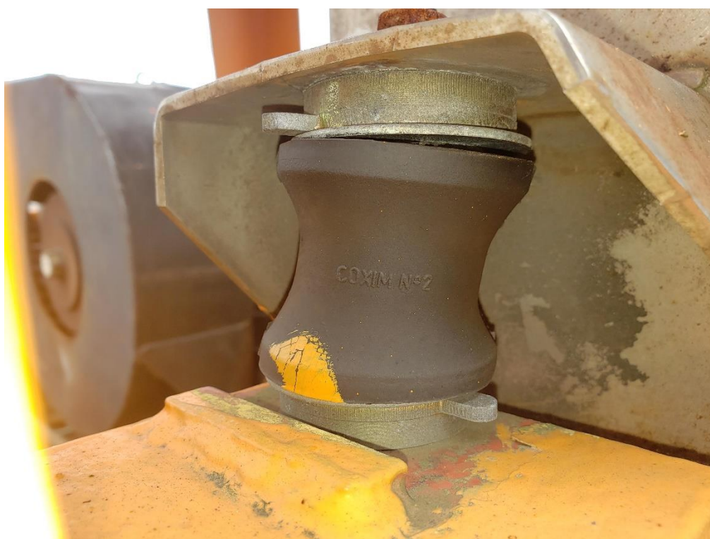
Figura 2 – coxim da caixa do painel elétrico quebrado.
