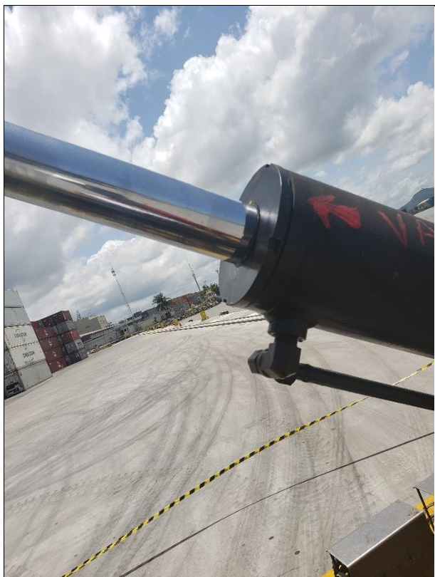
# item 2 – pequeno vazamento de óleo na tampa do cilindro do gravity point
