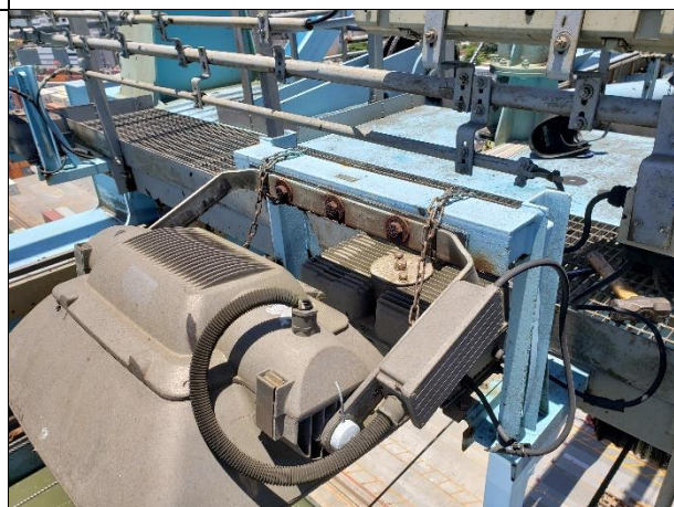
# item 49 – pontos de corrosão
