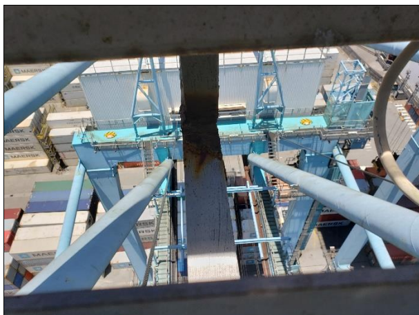
# item 54 – pontos de corrosão
