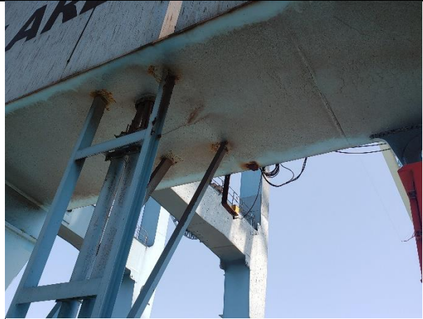
# item 5 – pontos com corrosão
