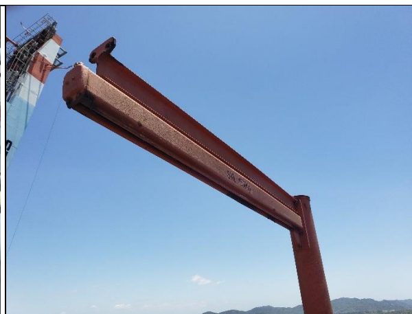
# item 54 – pontos de corrosão e guincho de carga não funciona
