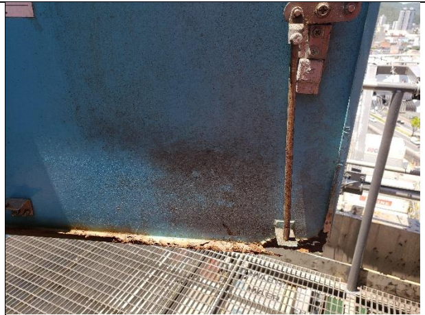
# item 39 – corrosão na estrutura da casa de unidade hidráulica.
