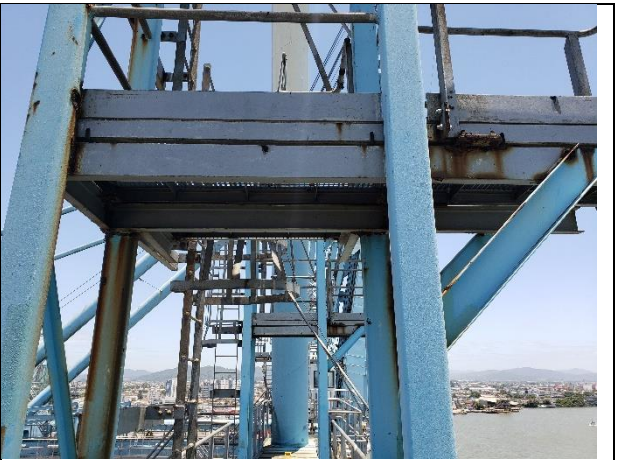
# item 49 – pontos de corrosão
