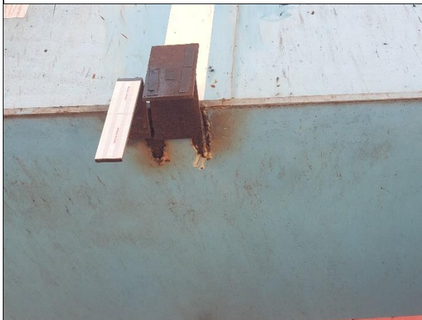
# item 5 – pontos com corrosão
