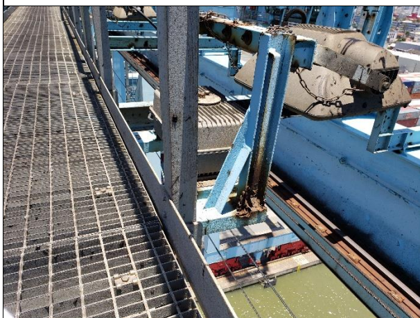
# item 49 – pontos de corrosão
