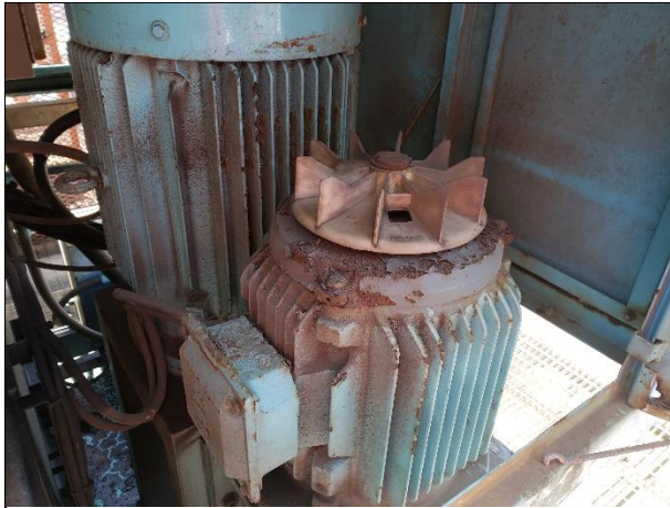
# item 39 – motor elétrico sem a tampa de proteção e corrosão.
