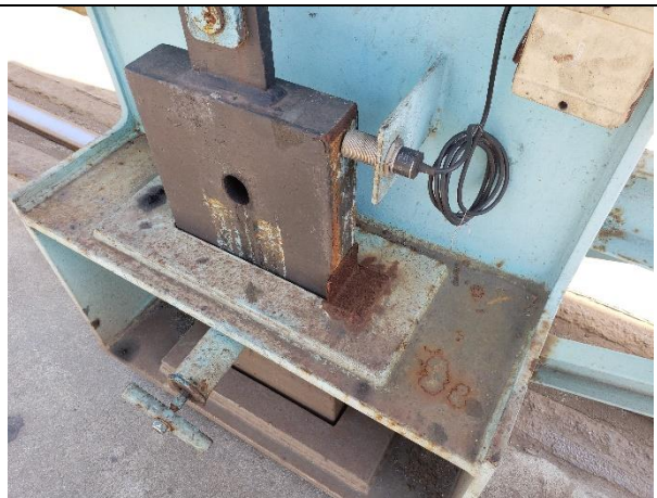
# item 3 – corrosão na estrutura do ponto de ancoragem e em alguns pontos não faz o travamento.
