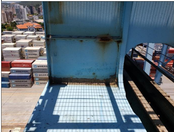
# item 49 – pontos de corrosão
