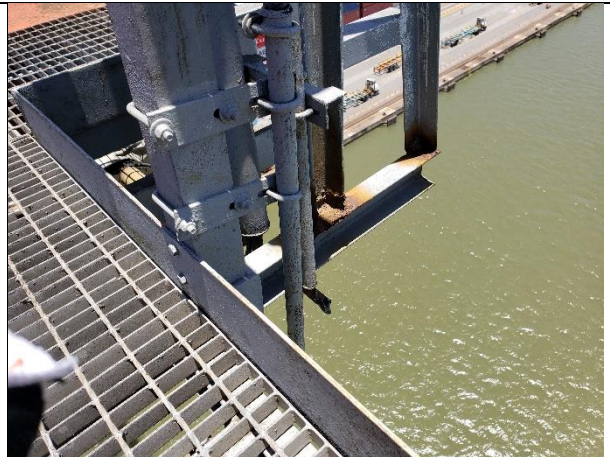
# item 49 – pontos de corrosão
