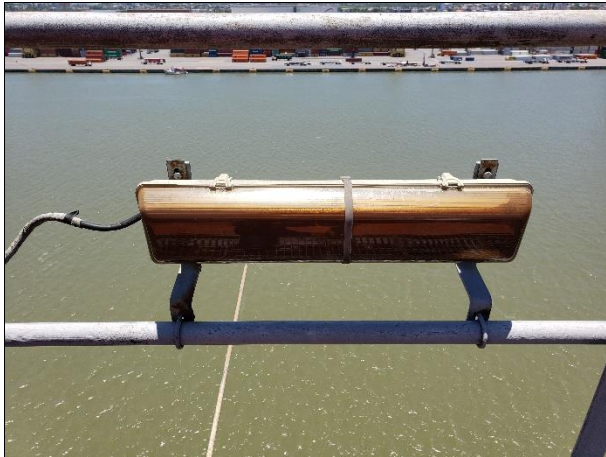
# item 49 – pontos de corrosão e luminaria com entrada de água
