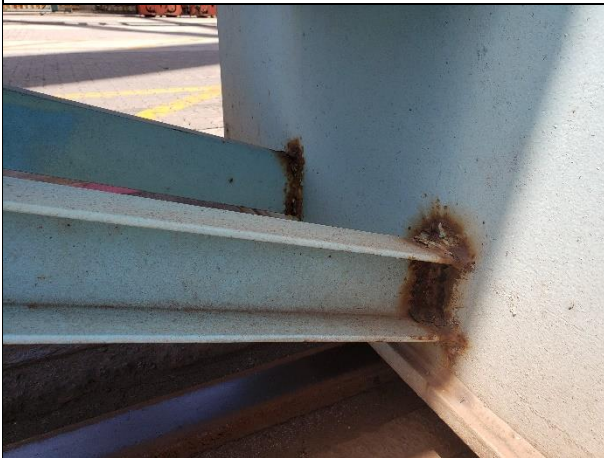
# item 5 – pontos com corrosão
