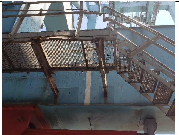
# item – 9 escada desalinhada
