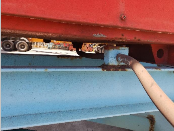
# item 5 – pontos com corrosão
