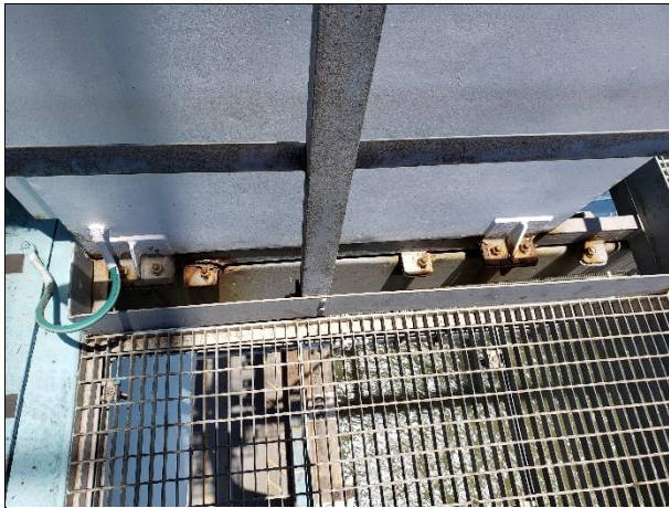
# item 49 – pontos de corrosão
