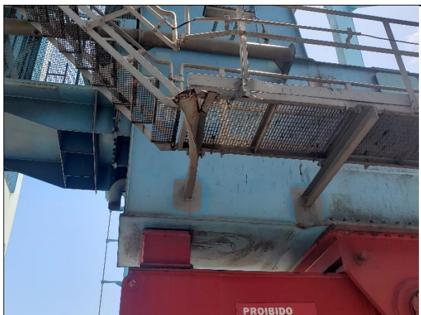
# item – 9 viga da base da escada amassado
