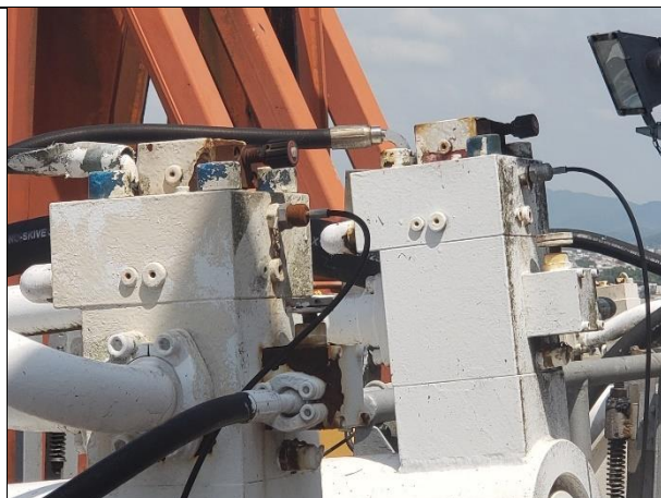
# item 39 – pontos de corrosão cilindro de TLS
