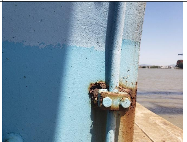
# item 5 – pontos com corrosão
