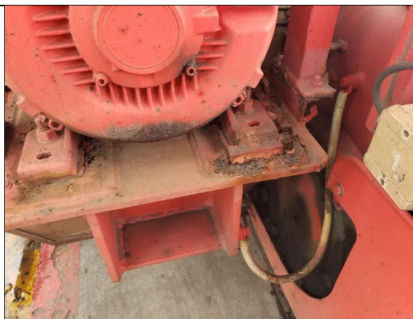
# item 5 – pontos com corrosão
