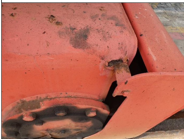
# item 5 – pontos com corrosão
