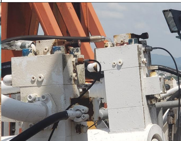
# item 39 – pontos de corrosão nos cilindros do TLS
