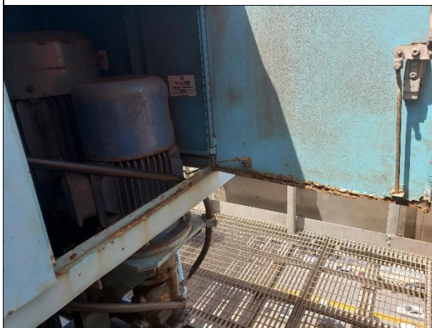
# item 33 – pontos de corrosão na casa de unidade hidráulica
