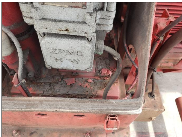
# item 5 – pontos com corrosão
