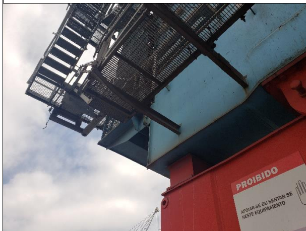
# item – 9 viga da base da escada amassado
