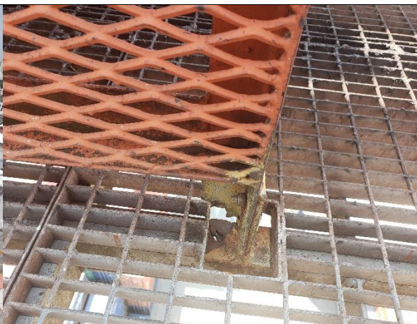
# item 33 – ponto de corrosão e parafuso solto na grade de proteção das polias.
